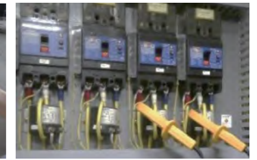
電力計測状況
