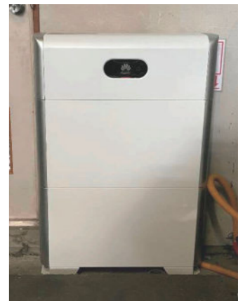
今回同時に導入した蓄電池
