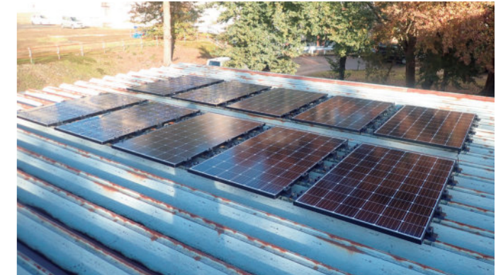
金属折板屋根に設置した高耐荷重の太陽電池パネル
